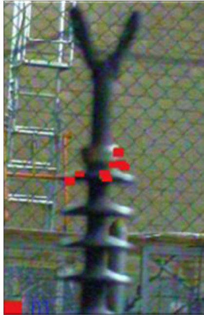
Figura 2.5 Descarga corona en la interfaz herraje-silicón, detectada mediante inspección ultravioleta (en color rojo).
