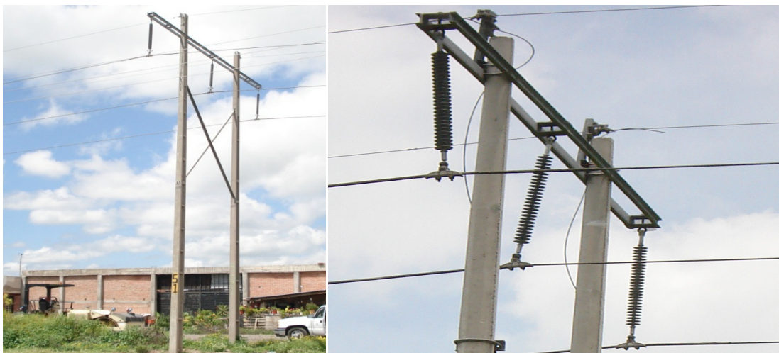
Figura 1.2 Aisladores poliméricos instalados en líneas de 115 kV.
